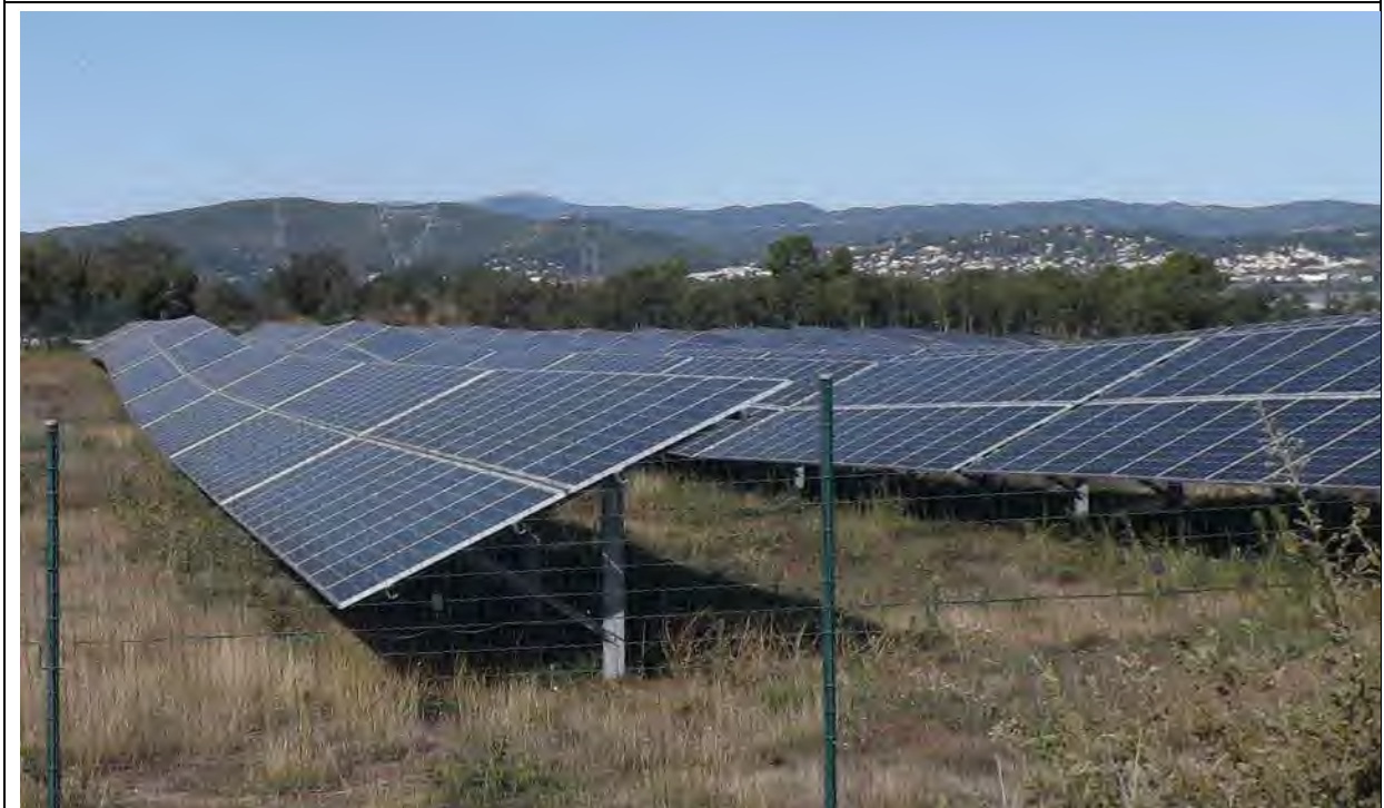
Parc photovoltaïque Engie des Coteaux de Rousset, Gréoux-les-Bains
